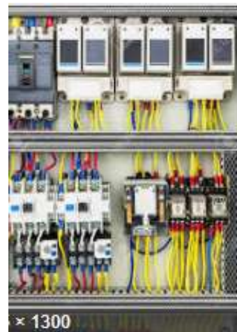
Fig. 13 - Tablero de Control Eléctrico
