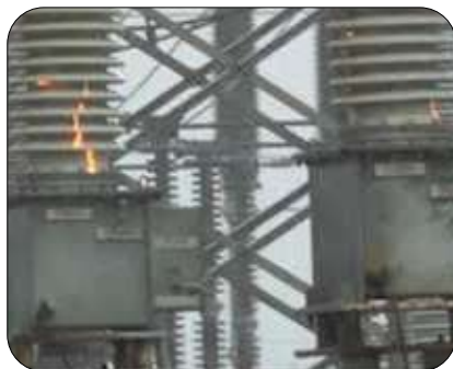
Fig 2. Contaminación de aislador de porcelana por condiciones atmosféricas
