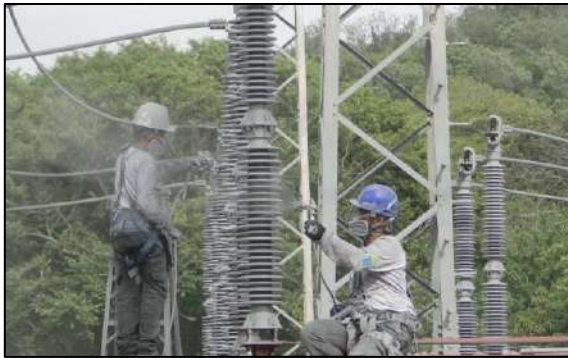
Figura 10. Aplicación de engomado a seccionador.
