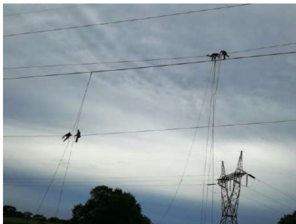
Gráfica 7. Foto real del a conexión entre las torres 177 de ln 816 y la 101 de la ln 805.
