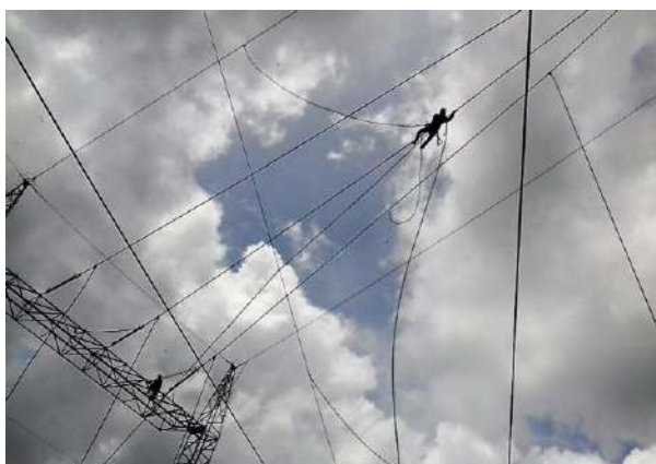
Gráfica 5. Foto real de conexión entre las lns 805 y 816 en pórticos de la subestación Sabanalarga.
