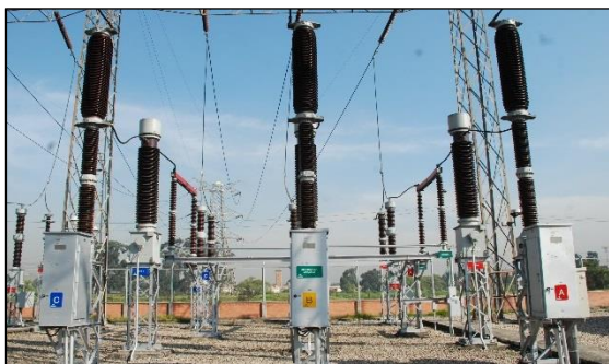
Fig 1 - Interruptor de Potencia 230 kV
