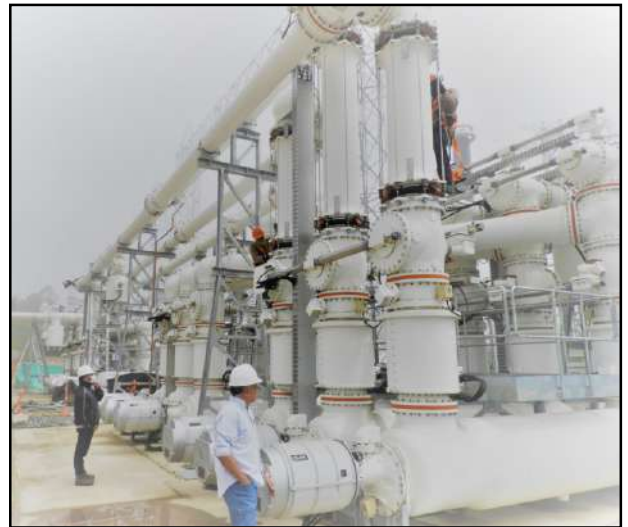
Foto 3. Subestación Encapsulada “GIS” a 500 kV. instalada a intemperie.
