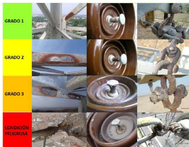
Figura 4. Patrones fotográficos de condición por corrosión en componentes de líneas y subestaciones.
