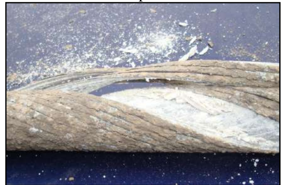
Foto 6. Cable conductor de energía afectado interna y externamente por la corrosión.
