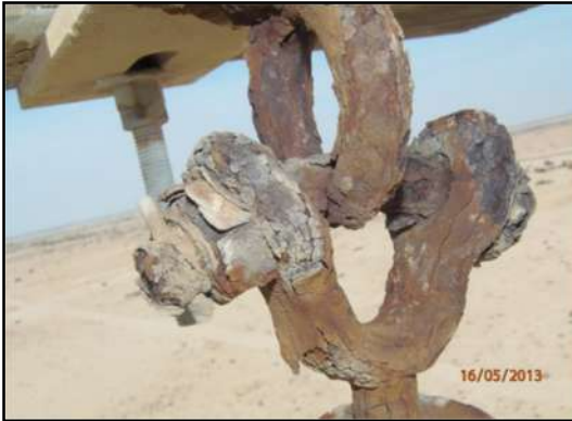
Foto 2. Herrajes de una línea de transmisión de energía afectados por la corrosión.
