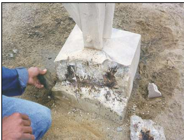
Foto 5. Cimentación de concreto deteriorada por la corrosión al utilizar material contaminado con sales.
